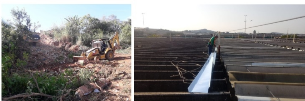
Período chuvoso motivou obras preventivas na área de expansão e no telhado do MLP
