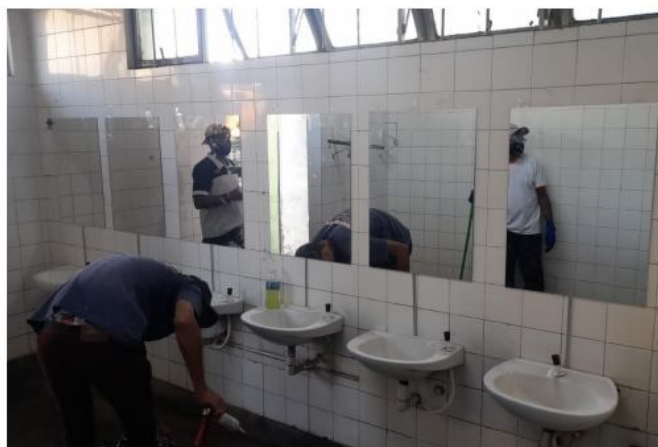
Espelhos quebrados de todos os banheiros do entreposto de Contagem foram trocados por novos
